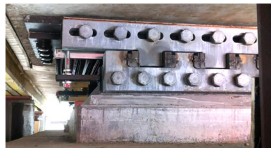
Eingebautes Lager. Während der Bauphase im Vorschub hatten temporäre Festhaltekonstruktionen ermöglicht, dass die Lager zum Teil wechselnde Funktionen im Baufortschritt übernehmen.
