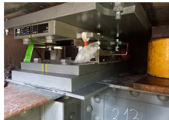
... und auch an dem oberen Lager ist die Situation nicht besser.
