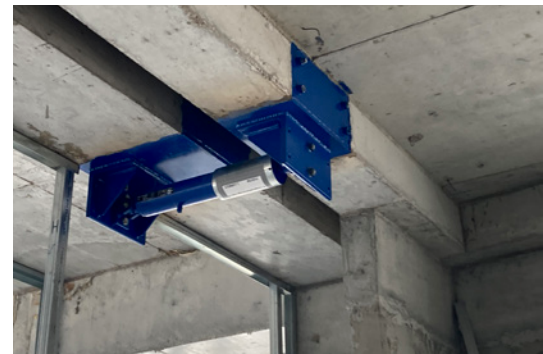
Einer der vier Hydraulikdämpfer zum Kippschutz des schmalen Gebäudekerns.
