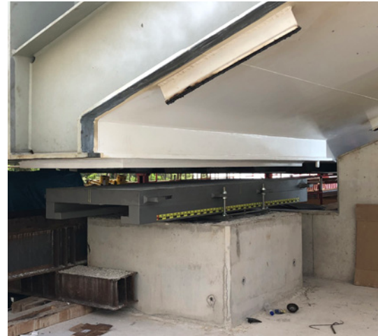
3 m langes Kalottenlager auf dem Betonsockel, das weiße Stahldeck muss noch abgesenkt werden. Die Lager nehmen Vertikalkräfte von bis zu 33 MN auf. Gut zu sehen ist die Klammerform der oberen Gleitplatte, die das Abheben der Brücke für Kräfte bis zu 2 MN verhindert.
