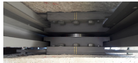
Achtung Spiegelbild! Das Lager (untere Hälfte) spiegelt sich im hochglänzenden Edelstahl-Gleitblech (oben). Oben und unten sind deshalb auch die Klammern gegen abhebende Kräfte doppelt zu sehen.
