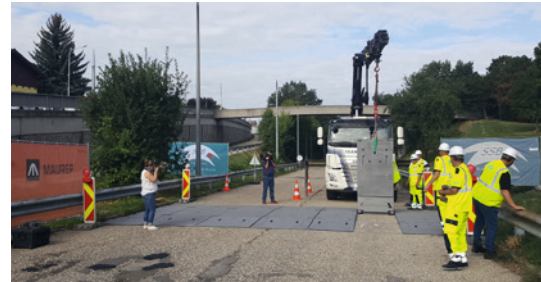
Sechs liegende und ein aufgeklapptes MMBS-Element im Test.
