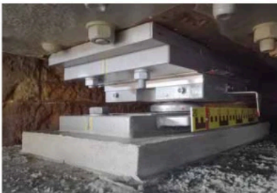
Mehr Platz gab es nicht: Extrem enge Raumsituation an einem Lager unter einem Stahlträger Foto: MAURER
