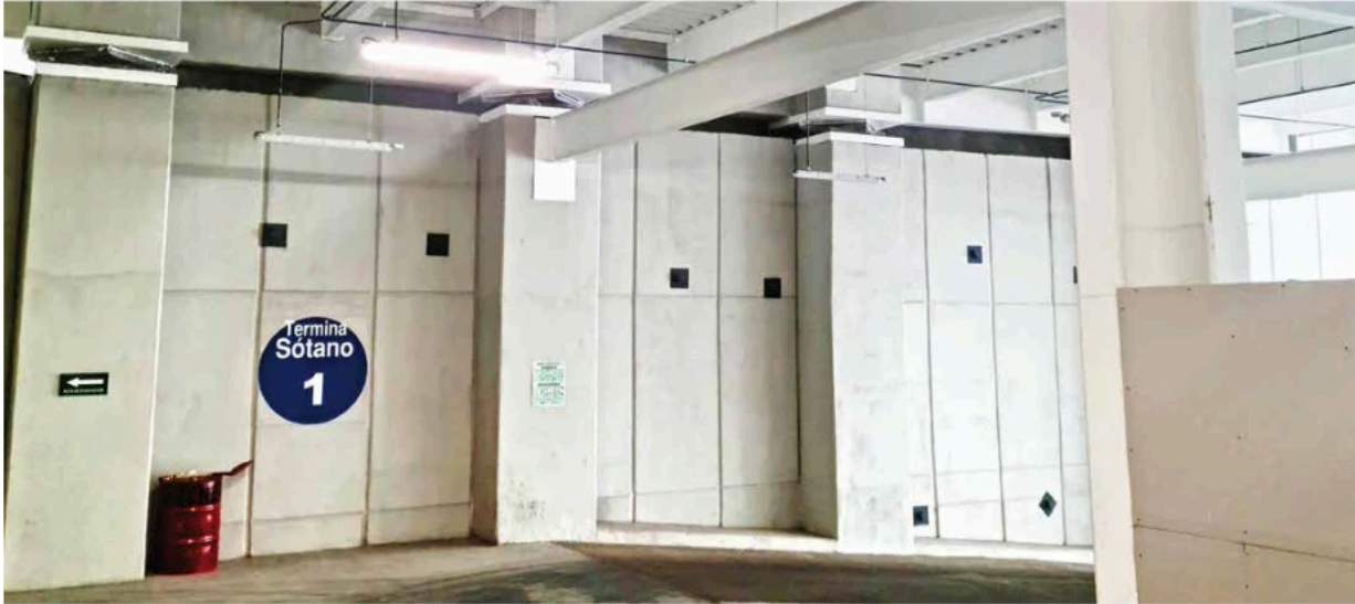
Vier der insgesamt 34 eingebauten SIP®-A-Lager oben auf den Stützsäulen. Unten sichtbar die Abfahrt zum unterirdischen Parkhaus. Foto: MAURER
