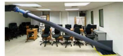
Eingebauter Hydraulikdämpfer: Oben mit Anschluss an die bestehende Gebäudestruktur. Foto: MAURER
