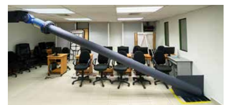
Eingebauter Hydraulikdämpfer: Oben mit Anschluss an die bestehende Gebäudestruktur. Foto: MAURER
