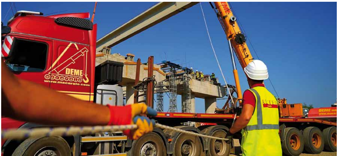
Autobahn Sibiu Pitesti, mehrere Brücken mit MAURER LRBs, SIP's.
