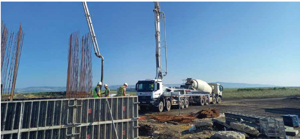
Autobahn A 0, mehrere Brücken mit MAURER Modulardehnfugen.
