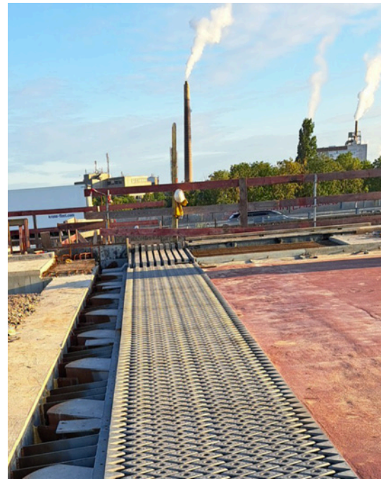
Lösbarer Fahrbahnübergang: Rechts bereits eingebunden, links noch offen – weil dies die besondere lösbare Verbindung wird und der Magerbeton noch nicht eingebaut ist.
