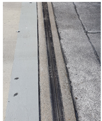
Elbepark Dresden: Kompakt-Dehnfuge K30-B und D1-B mit Betoflex-Verankerung für ein Parkhaus
