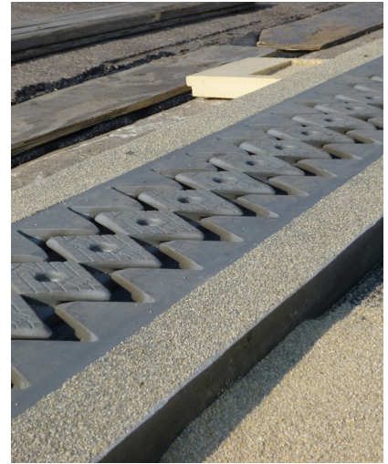
Dehnfuge XD2 mit Übergangsbalken
